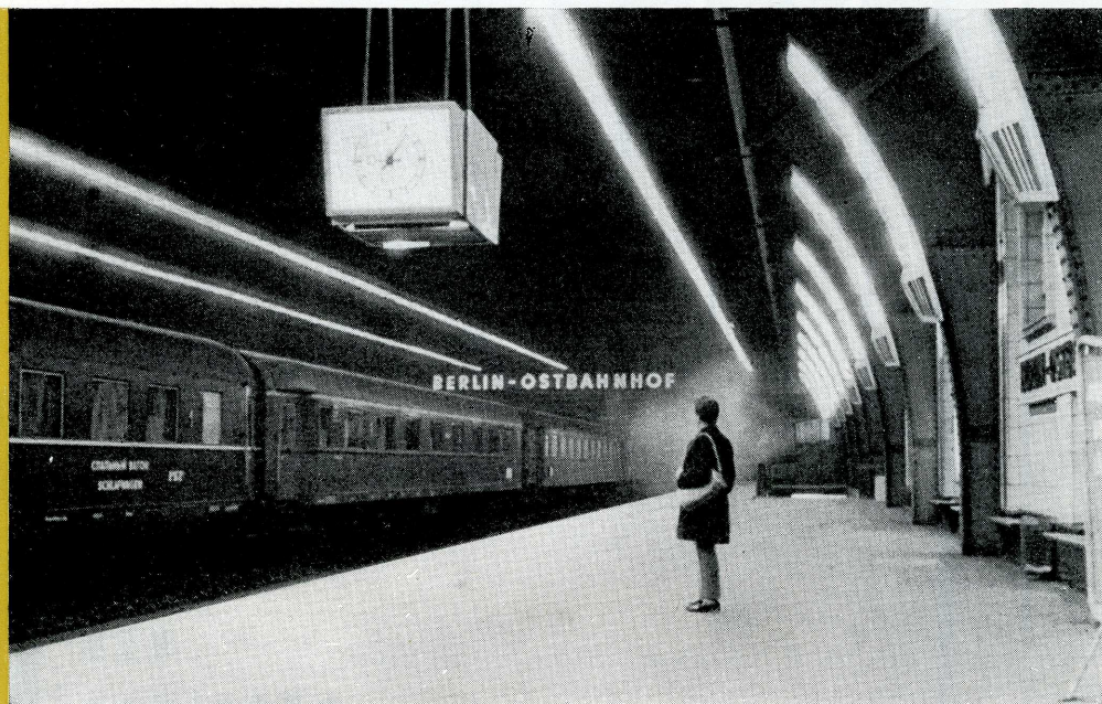
BGW-Leuchtstofflampen in Stab- und U-Form als Lichtquelle bei der Ausleuchtung von Bahnsteigen. Beleuchtungsstärke 200 Lux.
